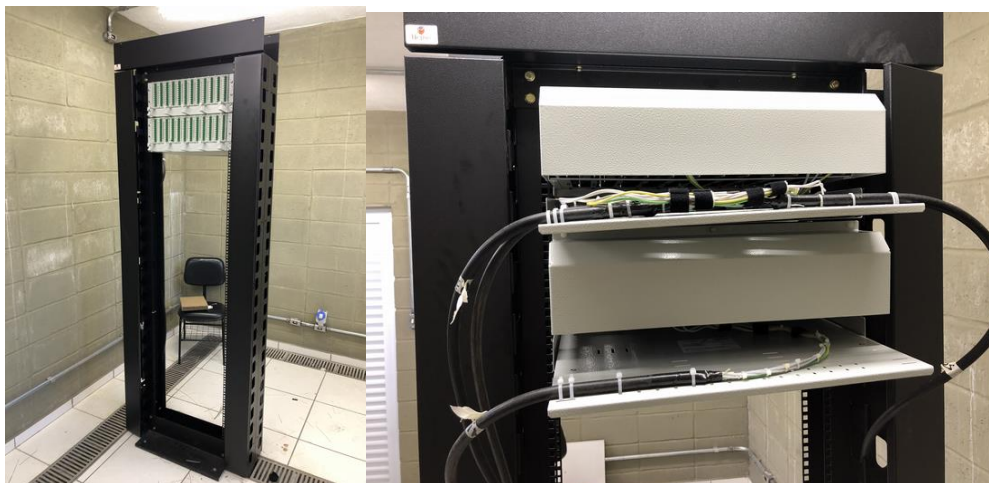
Figura 2 – Novos concentradores ópticos – Centro de Distribuição Norte
