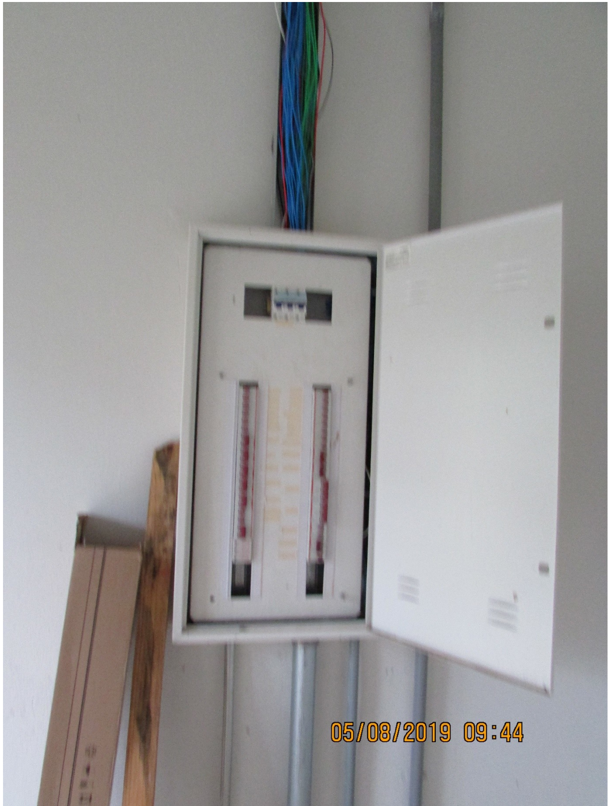
Foto 3: Quadro de comando rede elétrica.
