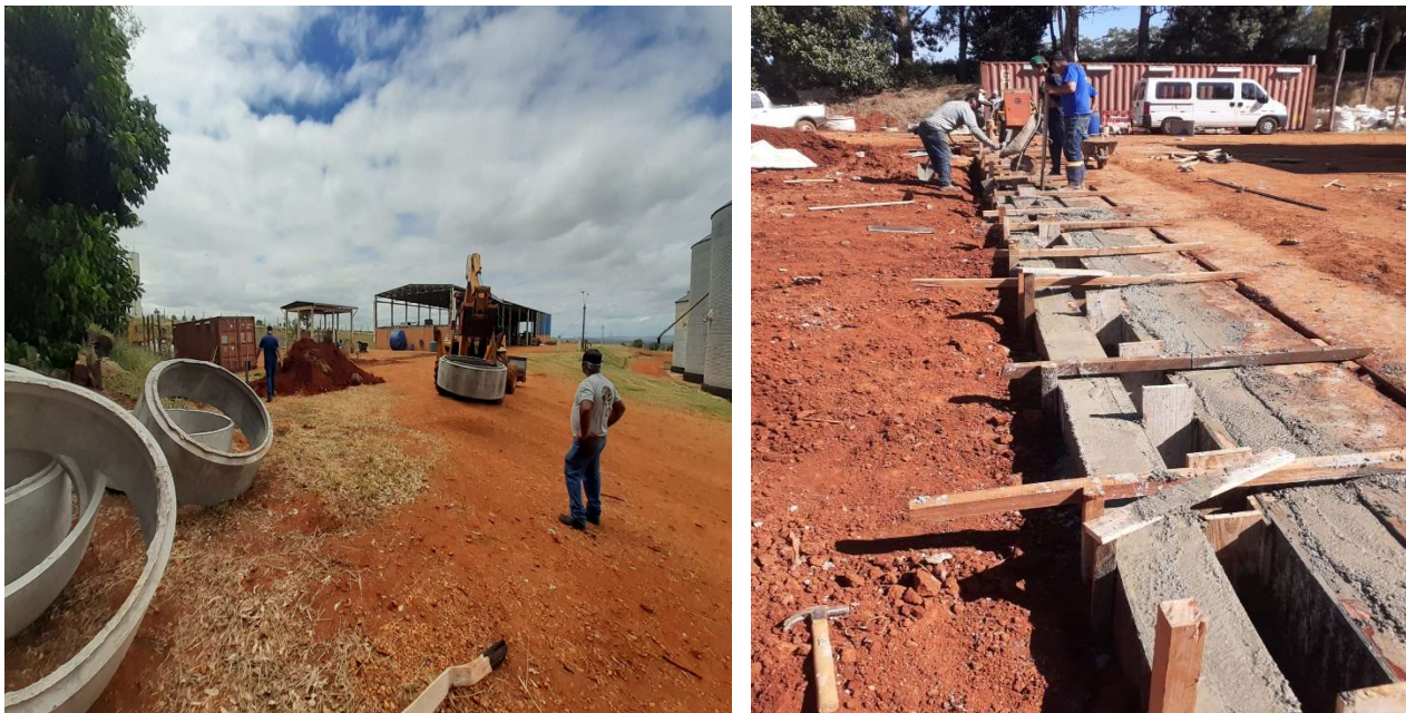
Figura 13. Estrutura para coleta de água lavador de máquinas.
