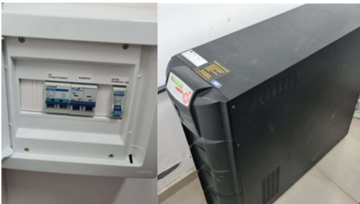
Figura 03. Ligação elétrica central de informática ao gerador Ciclo 01.
