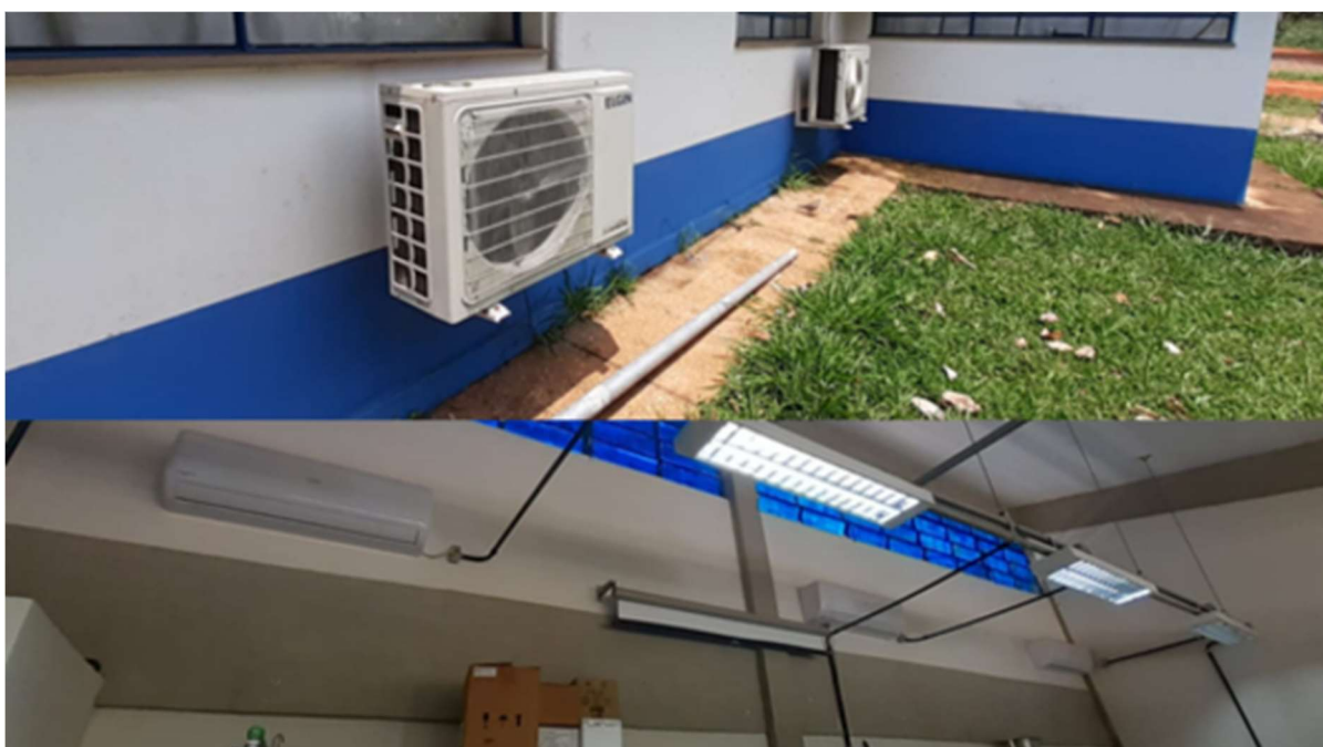
Figura 2. Estrutura elétrica para ar condicionado Laboratórios, Salas Informatizadas e Biblioteca
