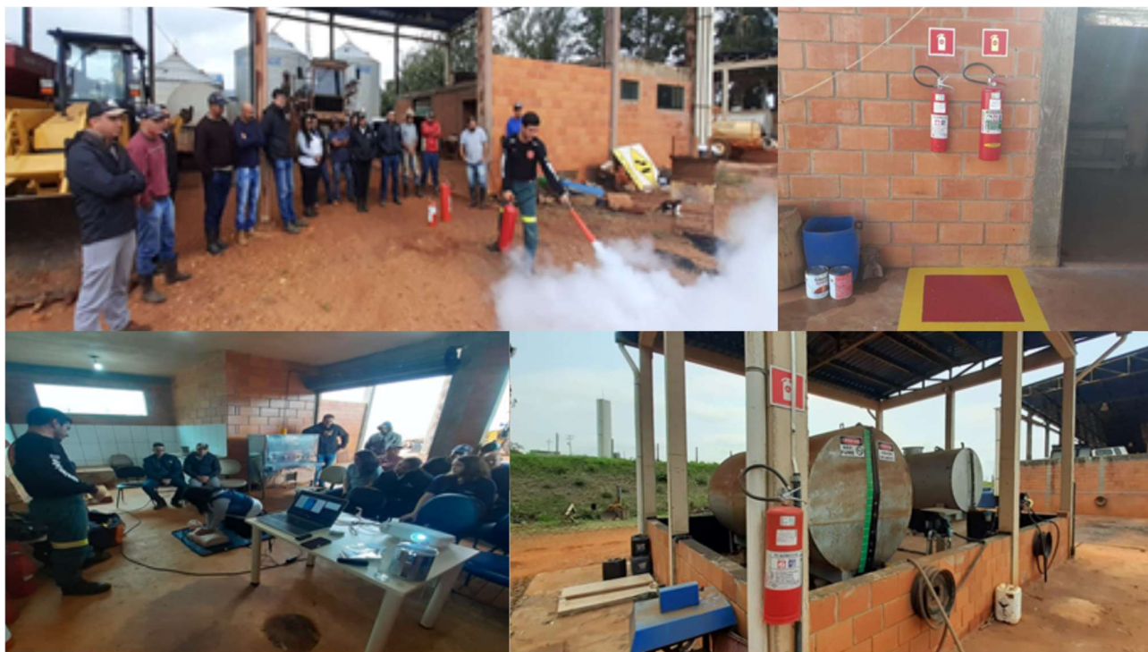
Figura 15. Sistema de combate a incêndio e treinamento da equipe
