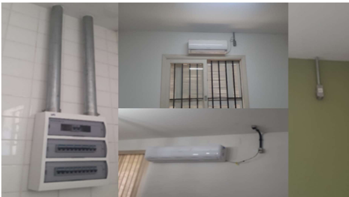
Figura 01. Estrutura elétrica para ar condicionado Bloco 04.
