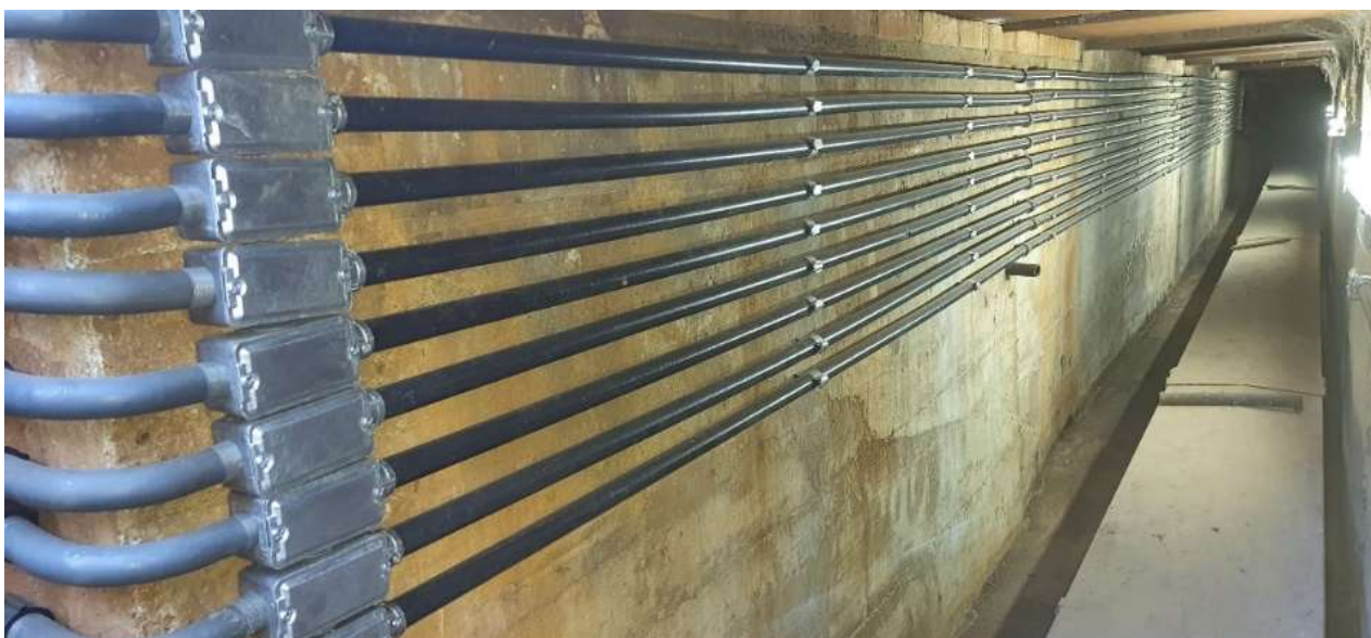
Figura 14. Estrutura elétrica dos silos e secadores.
