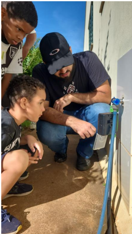
Figura 4: Observações sobre o timer do sistema de irrigação.
